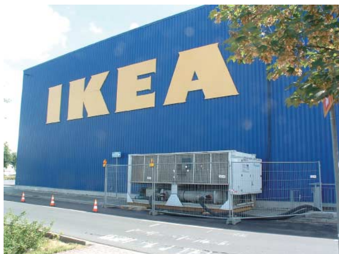
0,9-MW-Anlage bei der Versorgung eines schwedischen Möbelhauses
